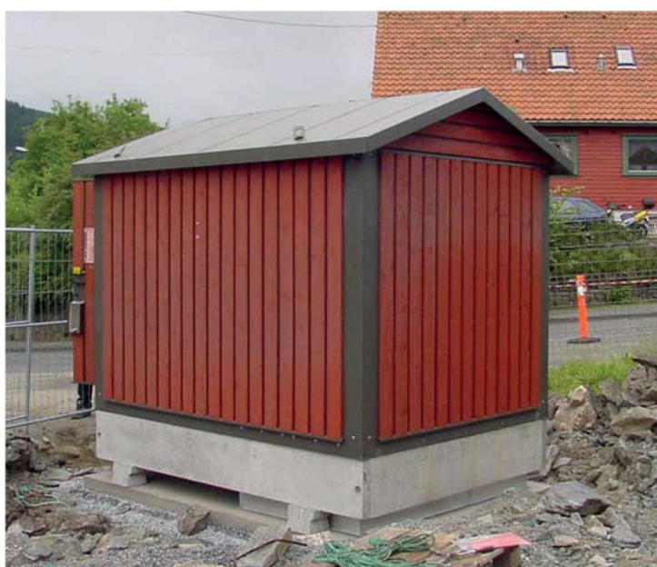
Figur 6. Prefabrikkert kiosk (bilde tatt av BKK AS)
